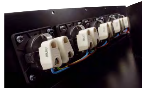
Die eingesetzten Armaturen sind von guter Qualität
